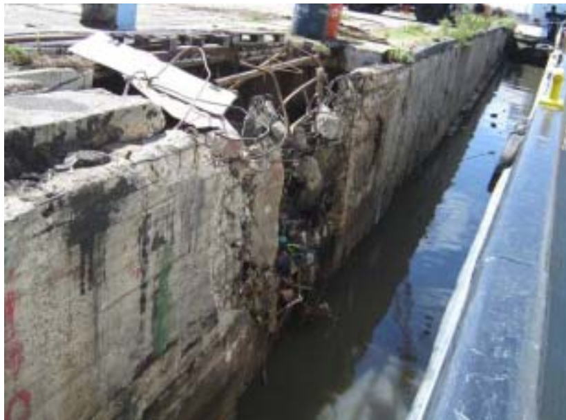
FRENTE OPERATIVO EN ZONA FLUVIOMARITIMA AFECTADO POR FALTA DE ADECUADO SISTEMA DE DEFENSAS.
