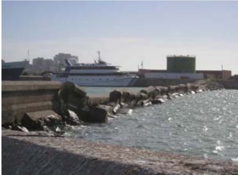
AFECTACION PROGRESIVA DE OBRA DE PROTECCION MARITIMA POR MODIFICACION DE REGIMEN HIDRAULICO.
