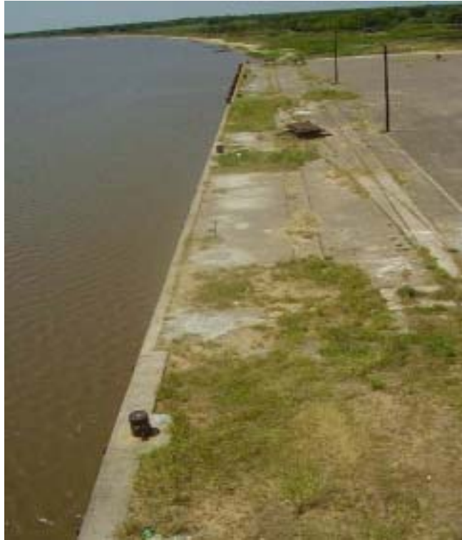
EMPLAZAMIENTO FLUVIAL CON ASENTAMIENTOS y ROTURA DEL PAVIMENTO POR FALTA DE MANTENIMIENTO EN SISTEMA DE DRENAJE.
