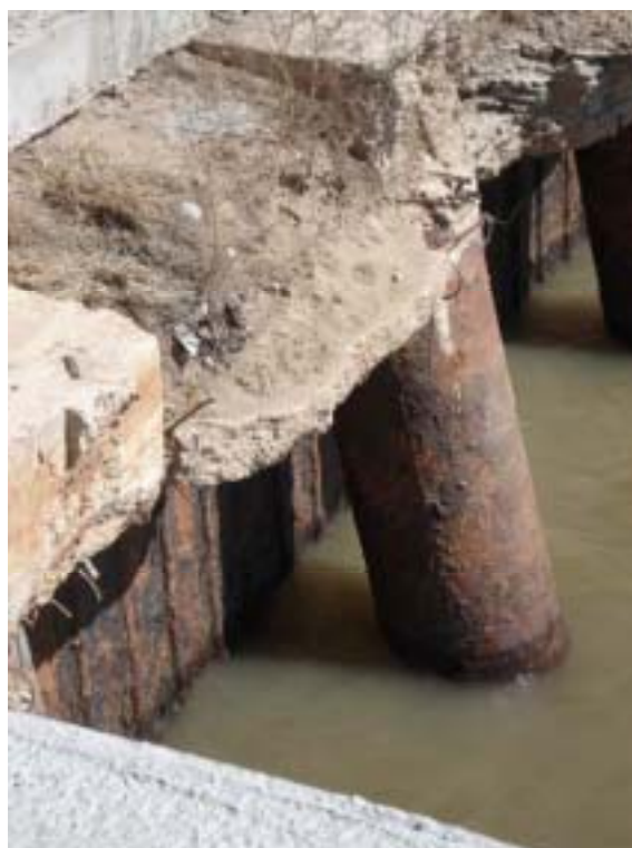
MUELLE DESTRUÍDO CON TABLESTACADO POSTERIOR Y PILOTES METÁLICOS SIN TRATAMIENTO DE PROTECCIÓN.
